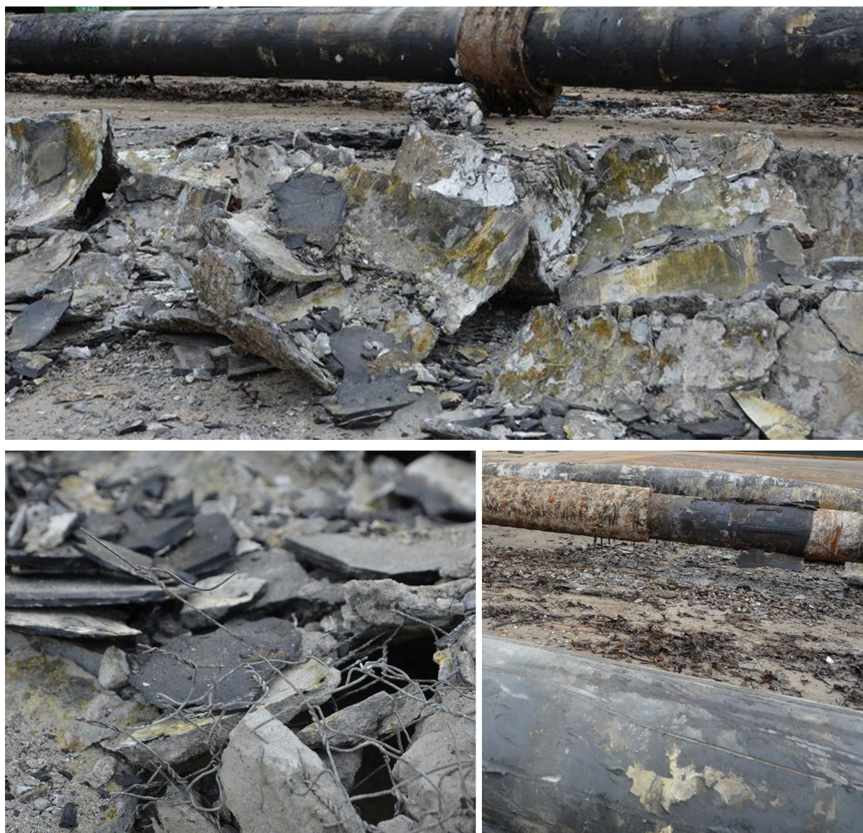
Figur 7-15. Eksempel på segregering av materialer (stålrør, kulltjære og betongkappe) fra et lederør.
