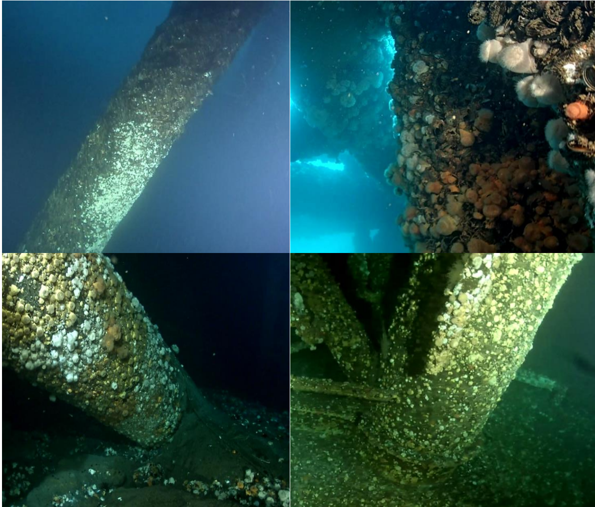
Figur V2-4. Eksempler på begroing fra stålunderstellet på DP fra inspeksjoner i 2017 / 2018. 4m øverst venstre, 23m øverst høyre, 63m (overgang kakshaug) nederst venstre, 73m nederst høyre.
